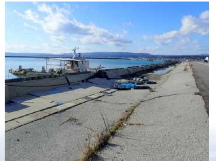
珠洲市蛸島：破損した漁港
